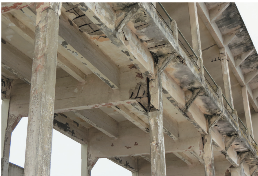
Figura 7. Imágenes tomadas en relevamiento del estado patológico de la estructura.
